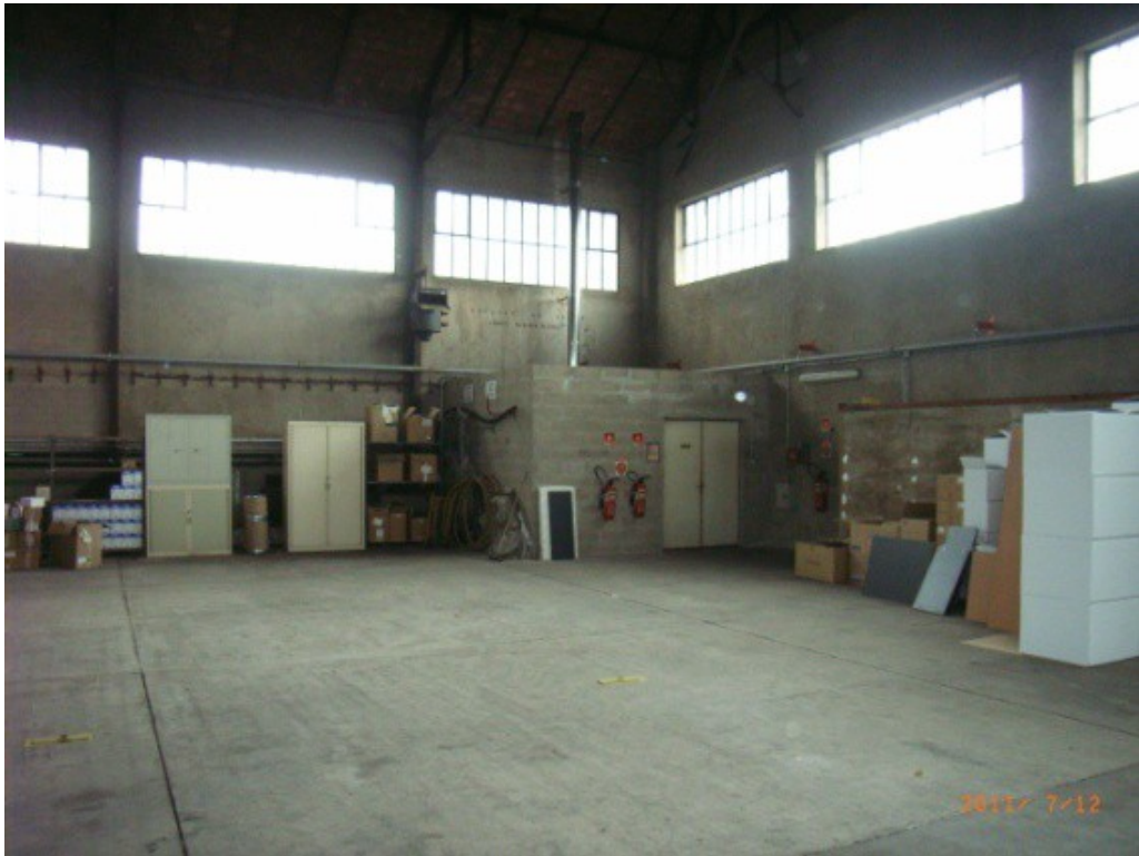
Photo 11 - Vue du local de la chaudière CHAPPEE
