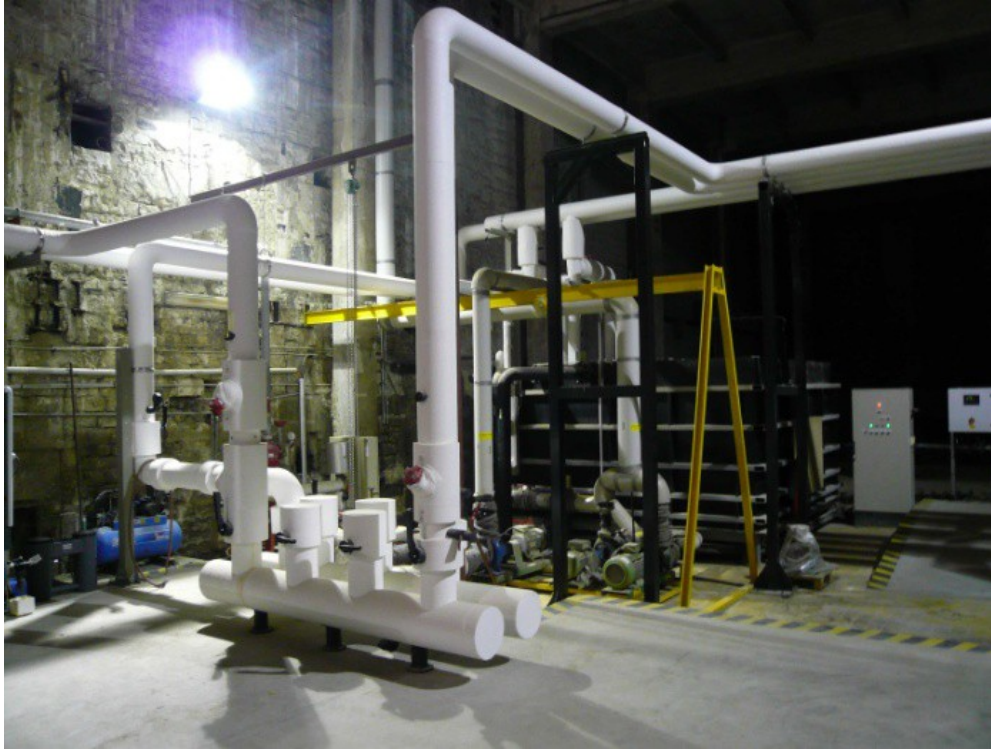
Photo 13 - Circuit de refroidissement
