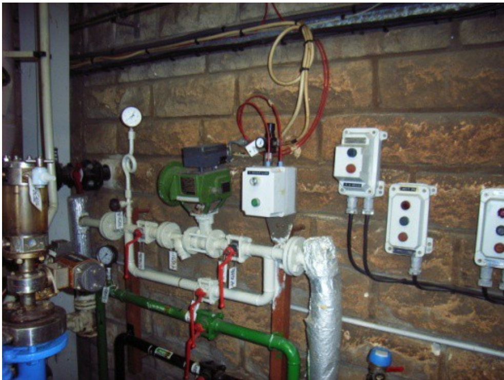
Photo 27 - Panoplie chauffage du réacteur R9
