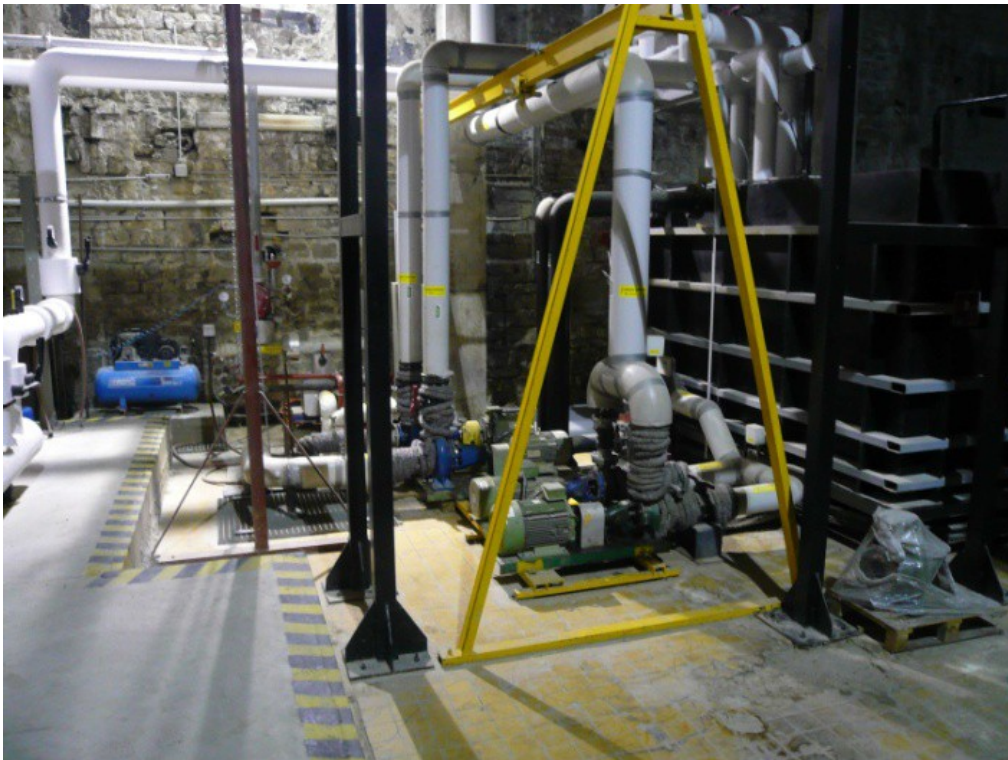
Photo 14 - Pompes du circuit de refroidissement
